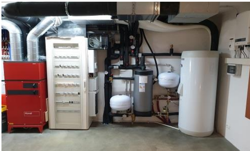
Centrale termica di villetta certificata CASA GAS FREE
